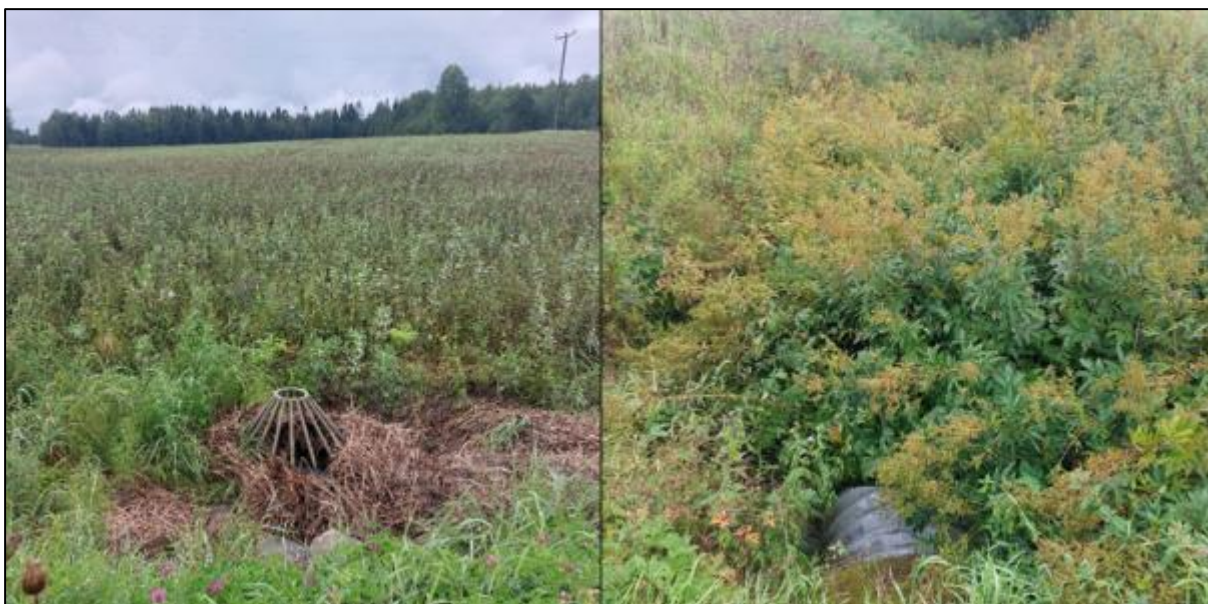
Figur 3-7. Eksempel på kum ved innløp. Det er kummen og ikke røret som definerer kapasitet. Dette er ved kritisk punkt 5, Langliveien
